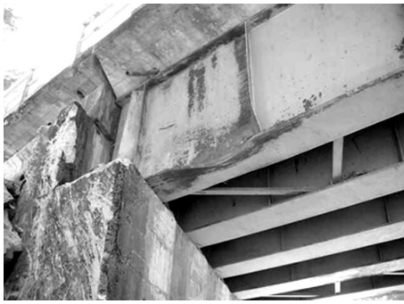
Figura 45. Corrosión e impacto, generó disminución de sección de viga. Puente Muros
