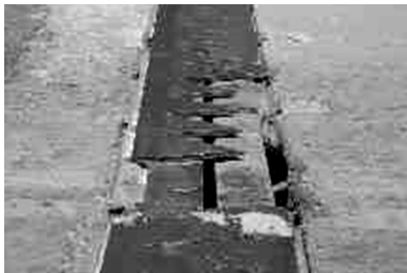
Figura 9. Desnivel y descomposición en junta dentada. Puente Dos Ríos
