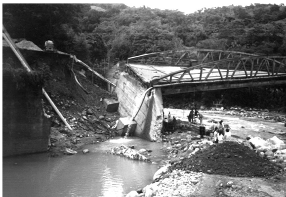
Figura 64. Colapso del estribo del Puente Unete
