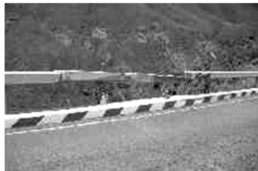
Figura 17. Barandas de concreto destruida por impacto. Puente Cañada Profunda No. 1.
