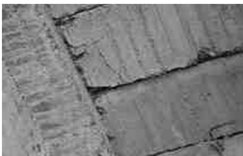
Figura 39. Falla de losas prefabricadas.
