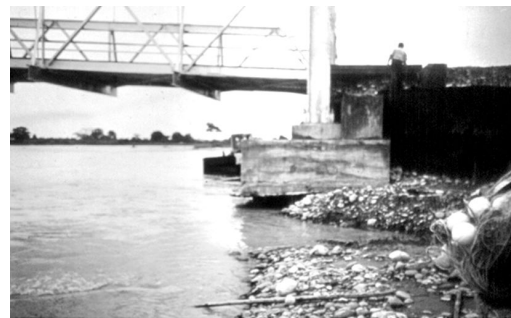
Figura 66. Socavación local en estribos
