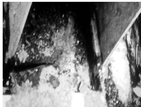
Figura 62. Problemas de corrosión, pérdida de sección de cordón inferior de acero
