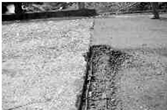
Figura 10. Daño en junta entre losa de aproximación y tablero. Puente el Tapón
