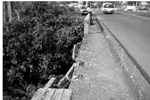
Figura 15. Falta de Barandas. Puente Tomas Castrillón
