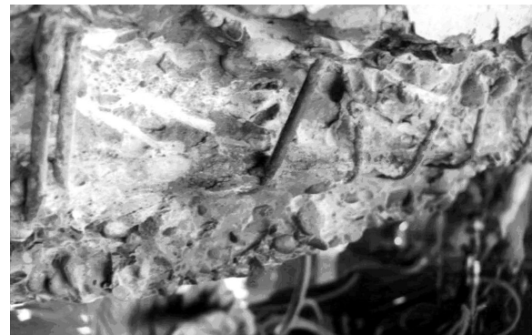
Figura 43. Corrosión por baja de pH y cloruros. Puente el Piñal
