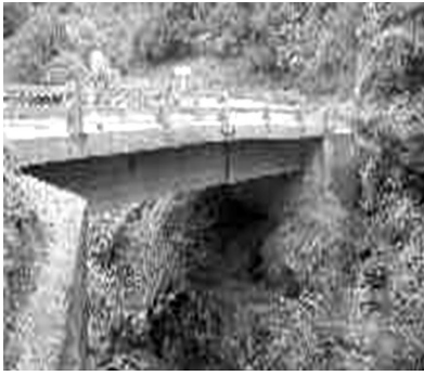
Figura 19. Falta de manejo de aguas de escorrentía. Puente Río Sucio
