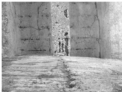
Figura 40. Acero expuesto y recubrimiento insuficiente.
