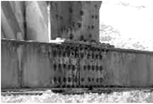
Figura 58. Corrosión generalizada en remaches
