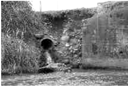
Figura 20. Erosión en el talud cerca al estribo, por manejo inadecuado de aguas. Puente el Playón
