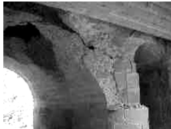
Figura 31. Infiltración y regular estado del concreto. Puente Guadalupe
