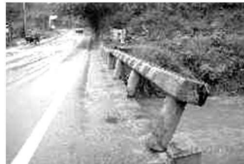
Figura 16. Barandas inestables por impacto. Puente Coello
