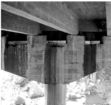
Figura 30. Alta concentración de humedad Puente Caima
