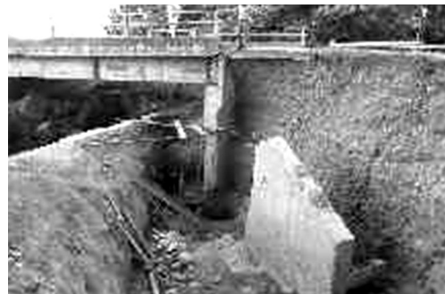
Figura 23. Erosión y Socavación. Puente El Cerrito
