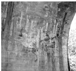
Figura 52. Manchas del concreto
