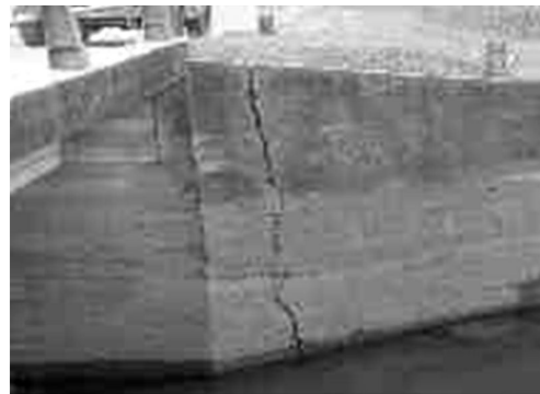
Figura 22. Falla por capacidad de carga debida al empuje. Puente Agua Bonita
