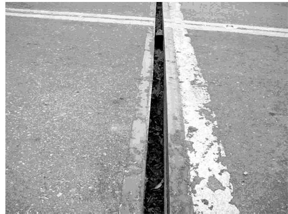
Figura 11. Desnivel y descomposición en juntas. Puente de los Ángeles
