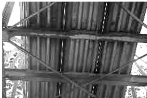
Figura 60. Oxidación de elementos estructurales
