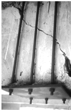
Figura 46. Grieta a cortante en viga principal de concreto reforzado. Espesor de la grieta mayor a 0.6mm
