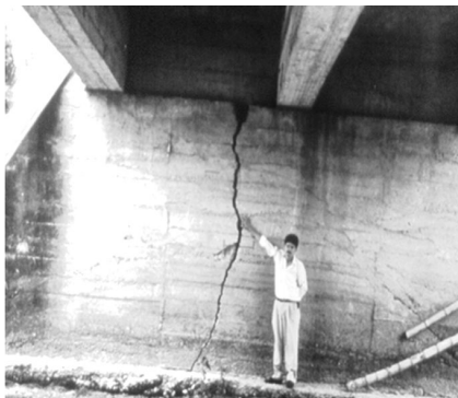
Figura 26. Grietas por falta de capacidad de carga
