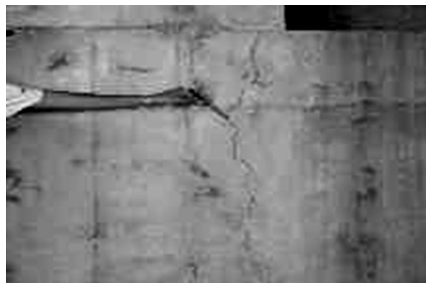
Figura 27. Problemas de capacidad de carga. Puente las Juntas
