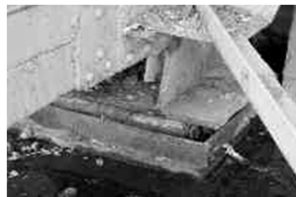
Figura 36. Corrosión y deterioro del apoyo. Puente Dos Ríos (Cauca)
