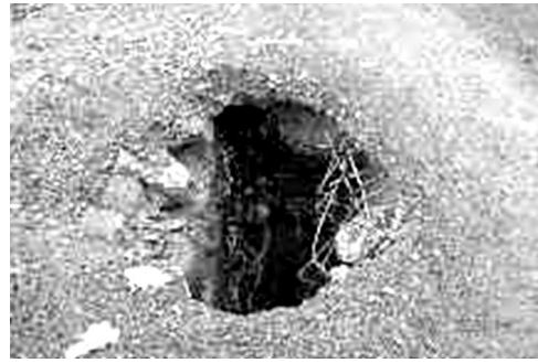
Figura 5. Falla de losa y carpeta de rodadura. Puente la Noche
