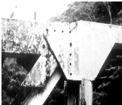
Figura 59. Falta de pernos, problemas de vibraciones y fatiga
