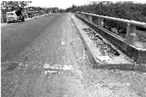
Figura 13. Daño estructural de anden. Puente Paso Elevado Sucromiles
