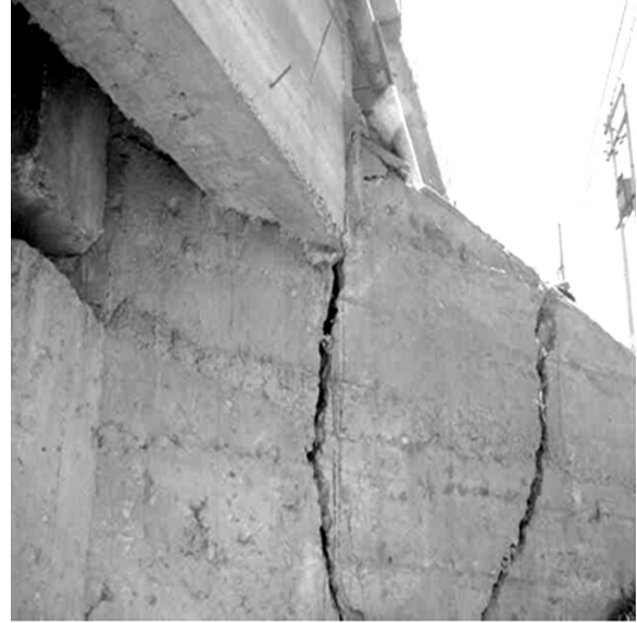
Figura 21. Grietas por falta de capacidad de carga de las aletas. Puente Venecia
