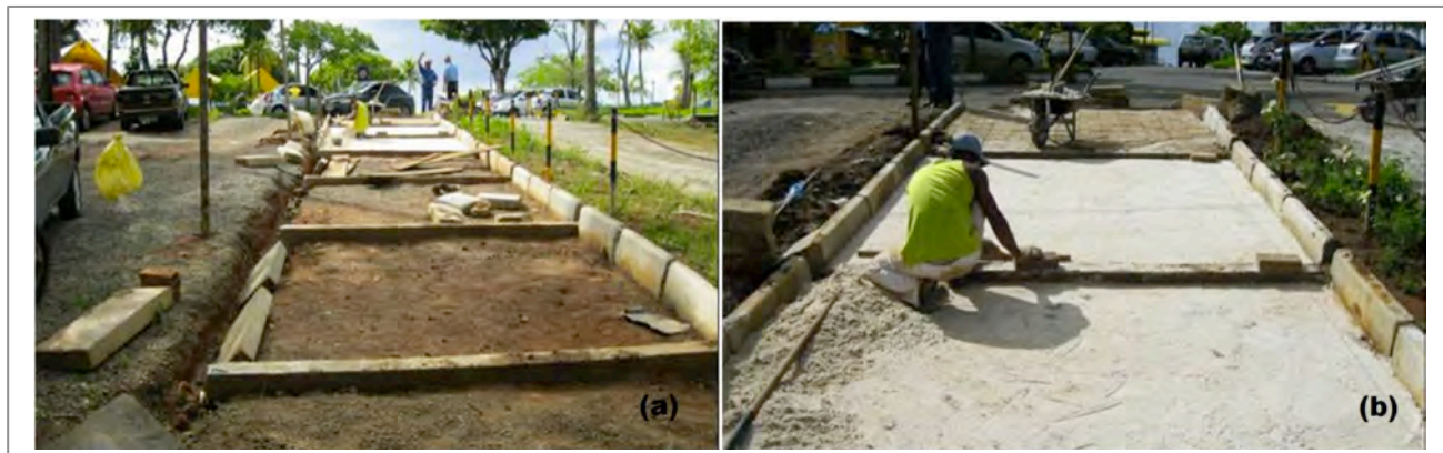
Figura 6. a) Proceso de colocación de los medios filos y de las vigas transversales; b) asentamiento de los bloques en la capa de arena
