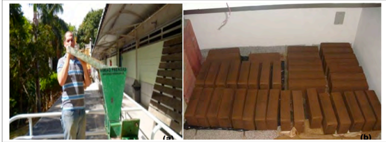
Figura 3. a) Prensado de los bloques; y b) Cura de los bloques de suelo cemento
